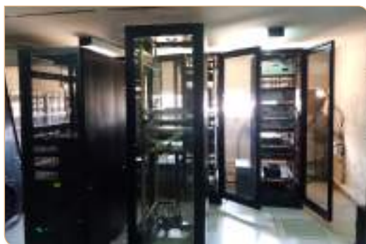
DATA CENTER DE LA UNSAC
